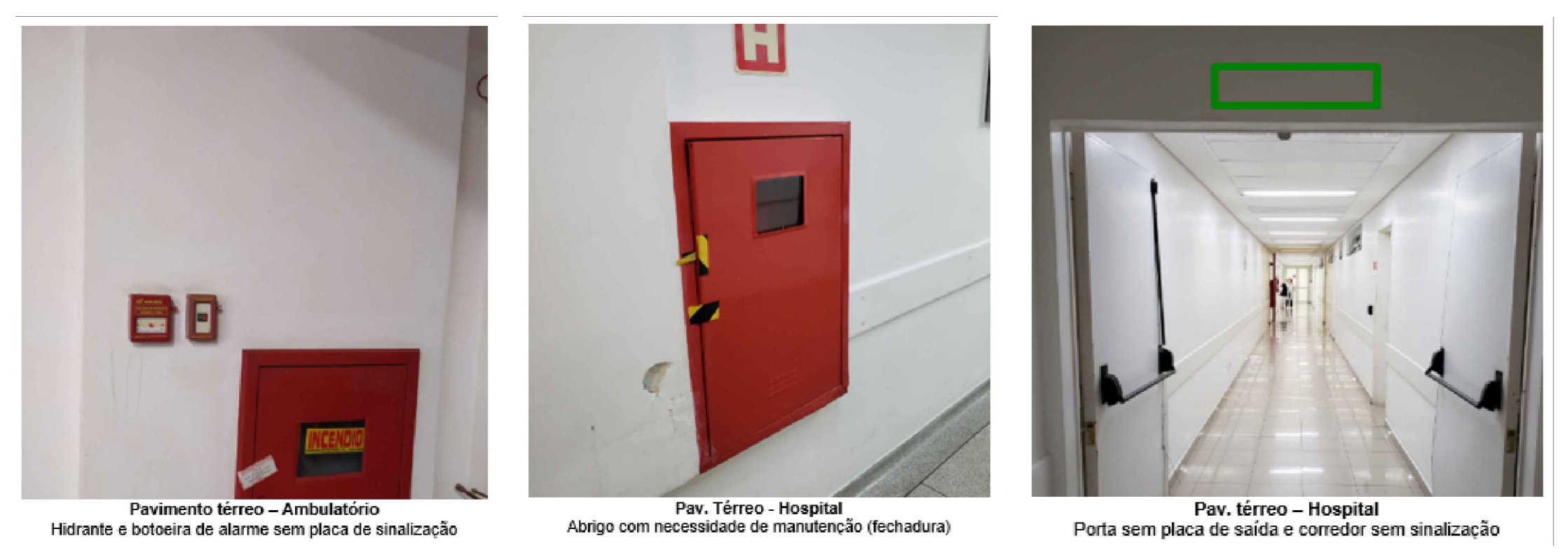
Pavimento térreo - Ambulatório Hidrante e botoneira de alarme sem placa de sinalização Pav. Térreo - Hospital Abrigo com necessidade de manutenção (techadura) Pav. térreo - Hospital Porta sem placa de saída e corredor sem sinalização
