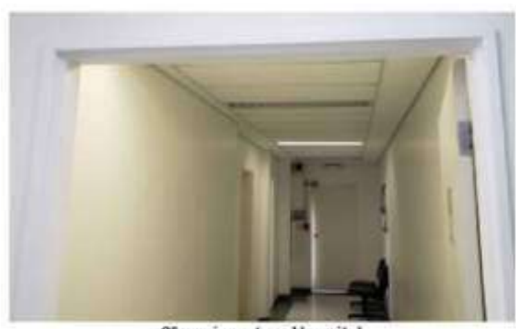
6º pavimento - Hospital Corredores sem placas de sinalização de rota de fuga
