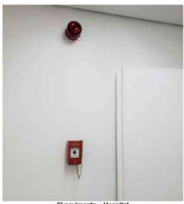
6º pavimento - Hospital Botoeira de alarme sem placa de sinalização
