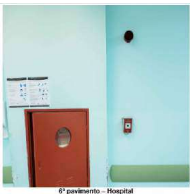
6º pavimento - Hospital Equipamentos sem placa de sinalização
