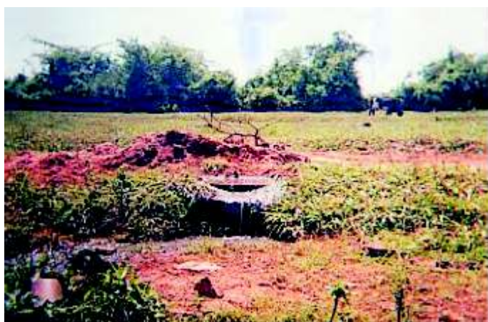
Figura 2. Fotografia de tubulação de esgoto.
