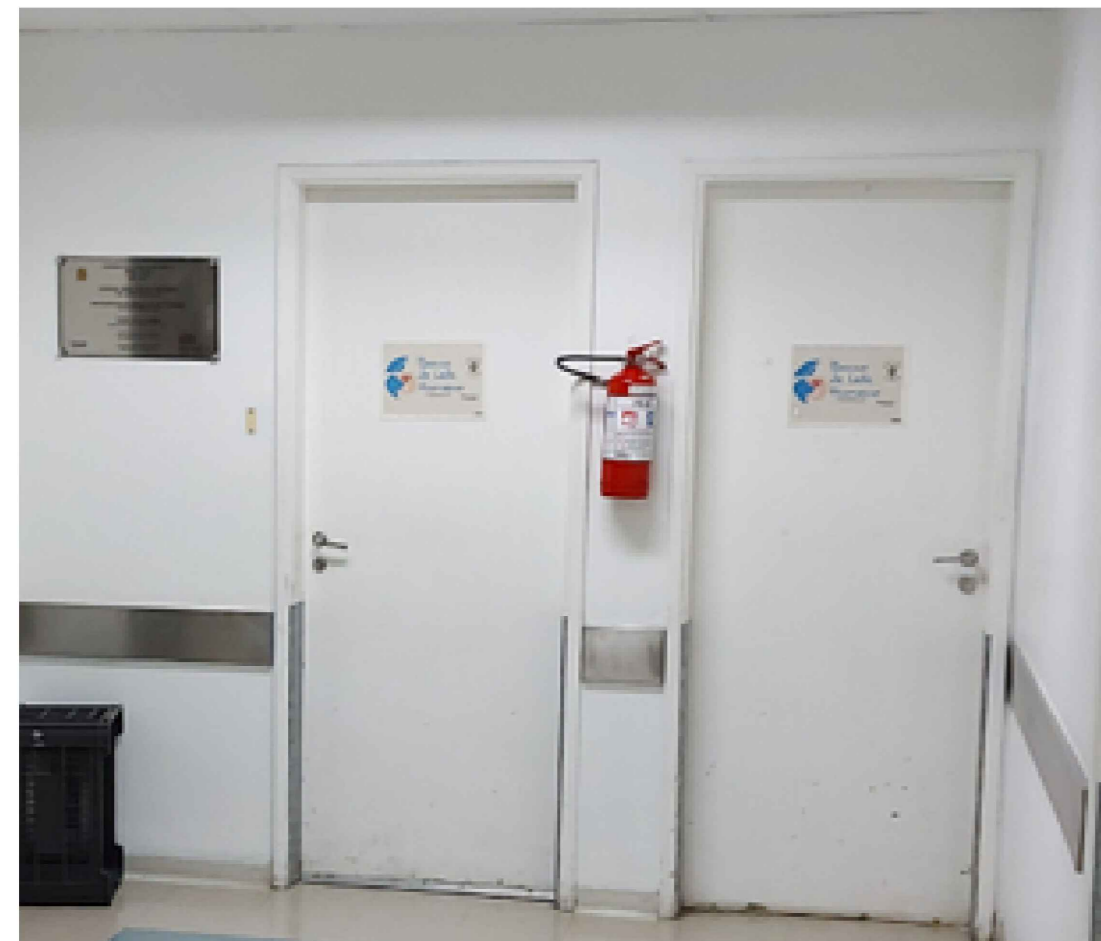
Hall dos elevadores Extintor sem placa de sinalização
