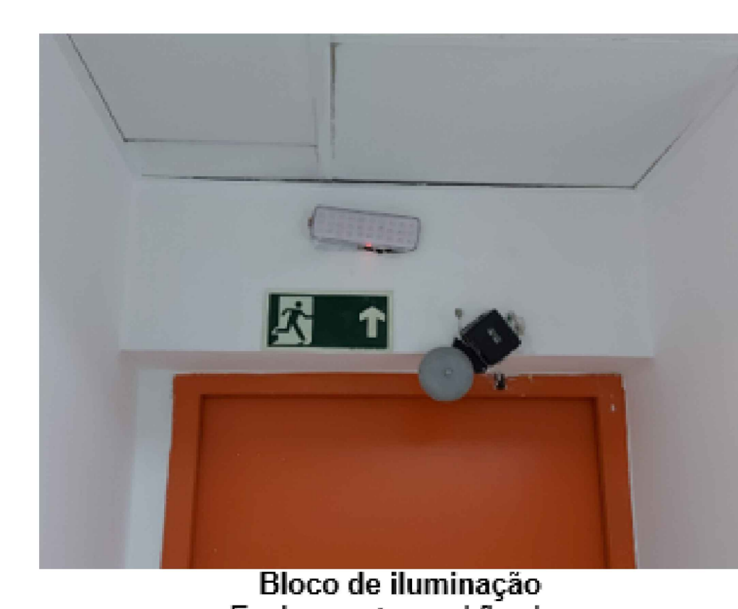
Bloco de iluminação Equipamentos mal fixados
