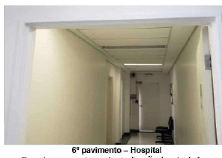
6º pavimento - Hospital Corredores sem placas de sinalização de rota de fuga
