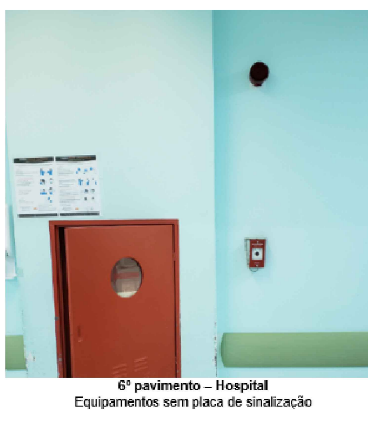
6º pavimento - Hospital Equipamentos sem placa de sinalização
